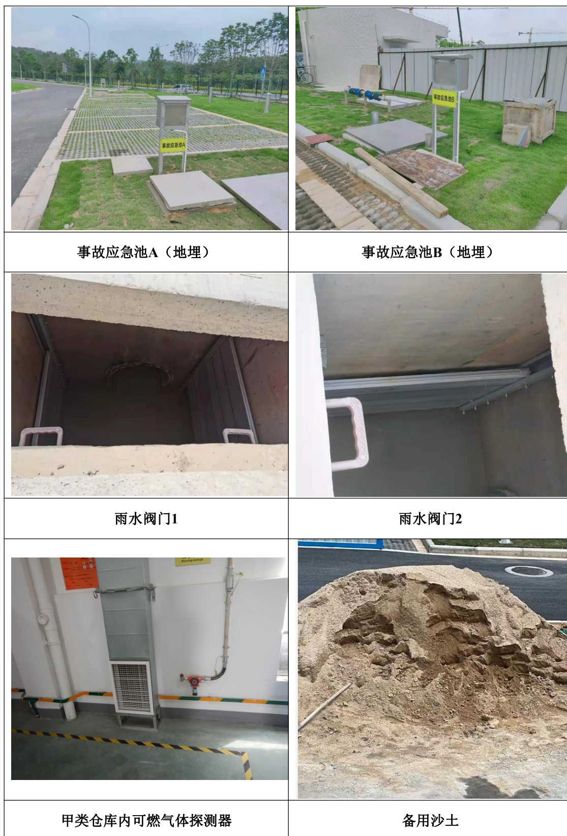
图 7.6-1 厂区现有环境风险防范措施照片
